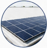
Centrales photovoltaïques toiture
